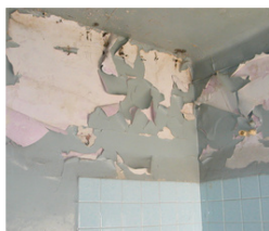
Peinture écaillée contenant du plomb
