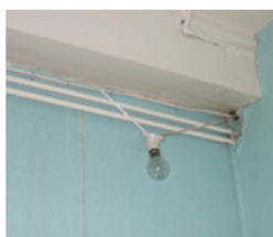
Éclairage insuffisant et dangereux
