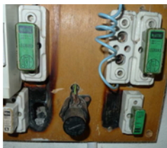
Branchements d'électricité vétustes
