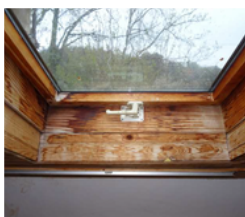
Absence de protection contre les infiltrations d'eau
