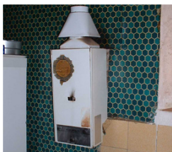
Absence de dispositif d'évacuation des gaz brûlés
