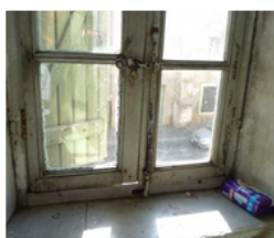
Menuiserie en mauvais état
